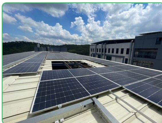
Rooftop solar panels 屋頂太陽能板
