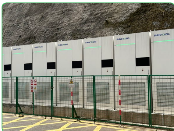
Large scale batteries 大型蓄電池
